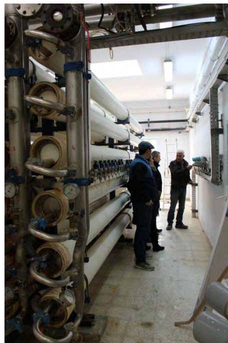
Figure 5 Station de traitement des eaux par osmose inverse (photo GRID-Genève, 2015)
