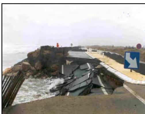
Figure 20 – Les impacts des événements météorologiques extrêmes (tempêtes, surcotes marines...) sur les routes et les structures du littoral méditerranéen
